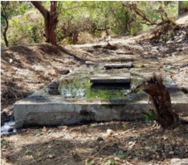
Sistema previo de tratamiento de aguas residuales.
